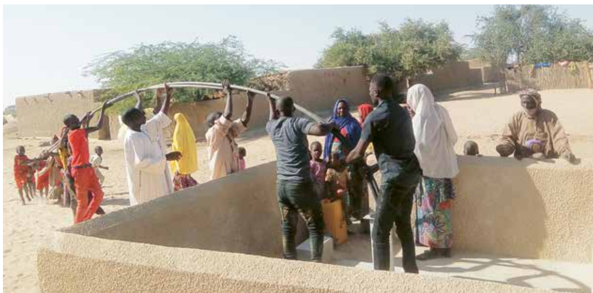
En ny handpump installeras i byn Laouré Blabrim i Niger och byborna får tillgång till rent vatten.
